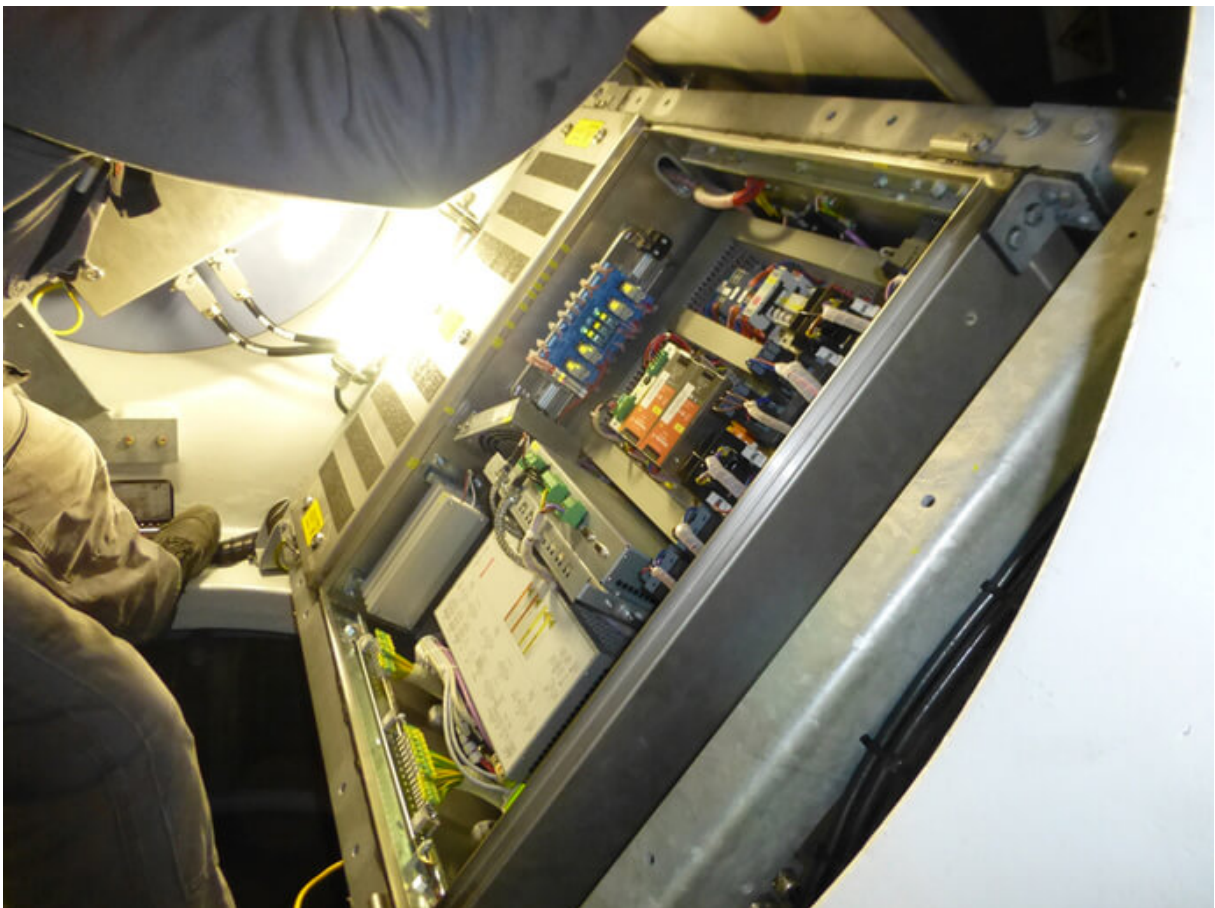
Abb. 2: Visuelle Prüfung der Nabe auf Beschädigungen
