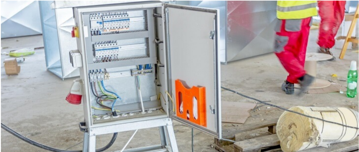
Baustromverteiler: Gefahr durch Kurzschluss (Bildquelle: roman023 /iStock / Getty Images Plus)
