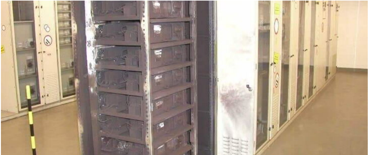
Geöffneter Einschubschrank nach Explosion der NH-Sicherung und nachfolgende Störlichtbogen. (Bildquelle: Dr.-Ing. Jens Jühling)
