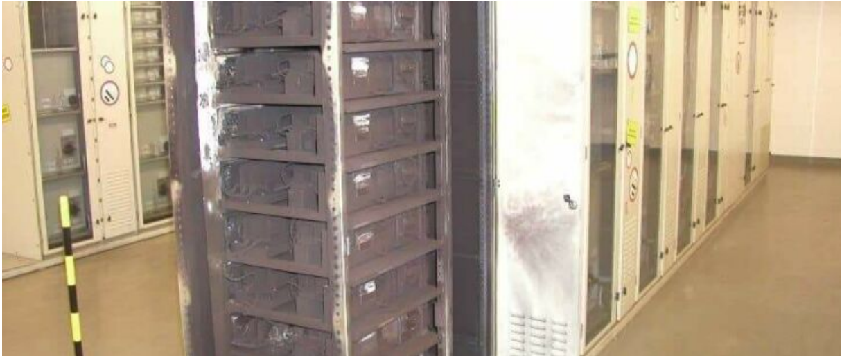
Geöffneter Einschubschrank nach Explosion der NH-Sicherung und nachfolgende Störlichtbogen. (Bildquelle: Dr.-Ing. Jens Jühling)
