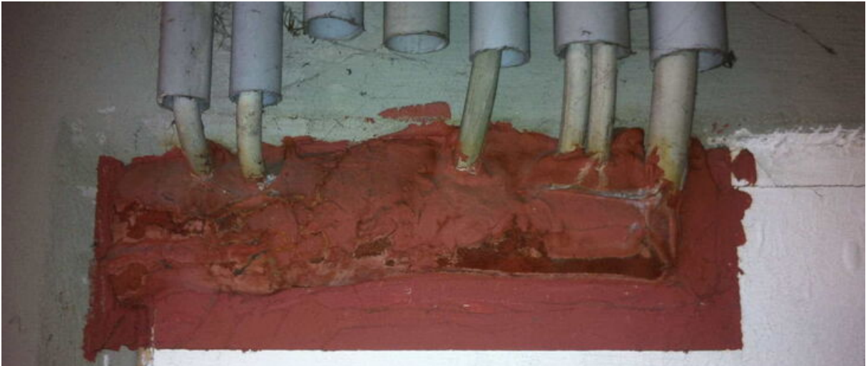
Deckendurchbruch mit Leitungsbündel (Bildquelle: Dr.-Ing. Jens Jühling)
