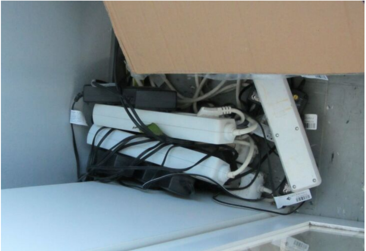
Unzulässiges Hintereinanderschalten von Steckdosenverteilern
