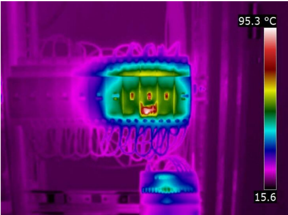
Überhitzung eines LS-Schalters aufgrund eines Isolationsfehlers
