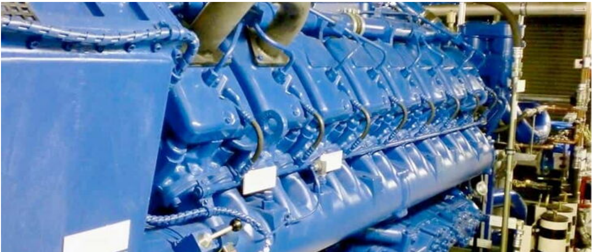
Hubkolbenverbrennungsmotor als Sicherheitsstromversorgung in einem Krankenhaus (Bildquelle: Dipl.-Ing. (FH) Christoph Schneppe)
