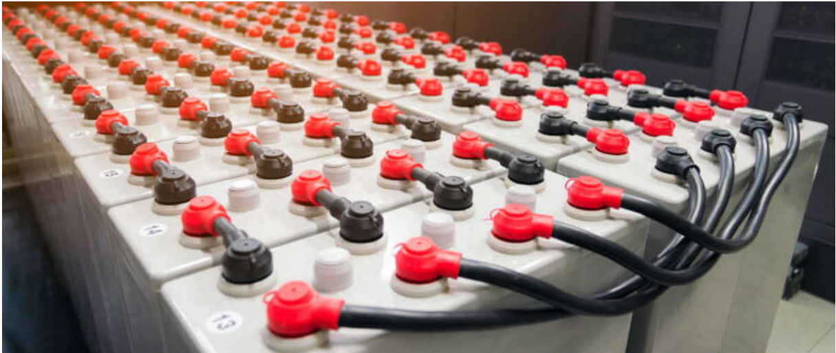
Batteriepack zur Sicherung der Stromversorgung (Bildquelle: tongpatong/iStock/Getty Images Plus)
