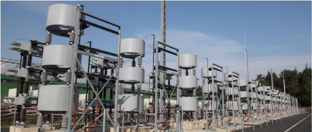
Eine in einem Dampfkraftwerk installierte Mittelspannungsanlage (Bildquelle: Condensator Dominit)
