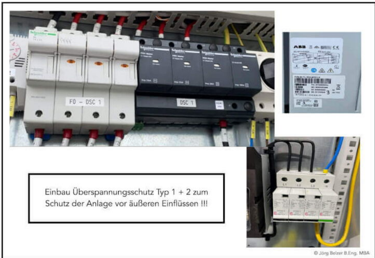
Fachgerechte Installation des Überspannungsschutzes (Bildquelle: Jörg Belzer, B.Eng. MBA)
