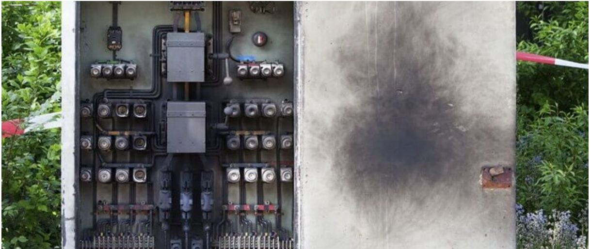
Beispiel eines Schaltschranks nach einem Stromunfall. War ein Kurzschluss schuld? (Bildquelle: Peter de Kievith/iStock/Thinkstock)
