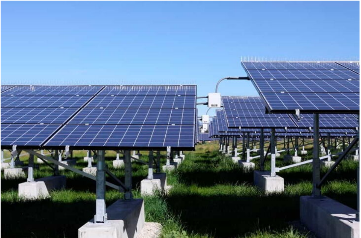
Beschädigte Kabel an der Photovoltaikanlage können zu einem Lichtbogen führen. (Bildquelle: Stocktrek Images/Stocktrek Images/Thinkstock)
