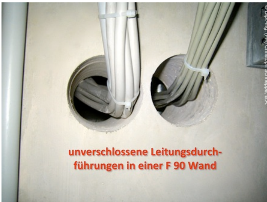
Unverschlossene Leitungsdurchführungen in einer F 90 Wand
