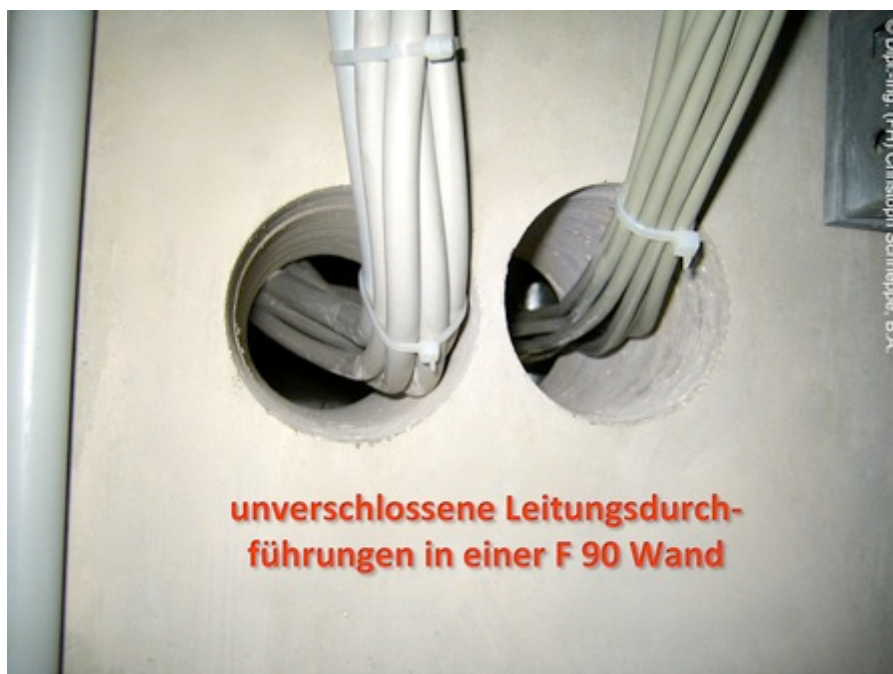
Unverschlossene Leitungsdurchführungen in einer F 90 Wand
