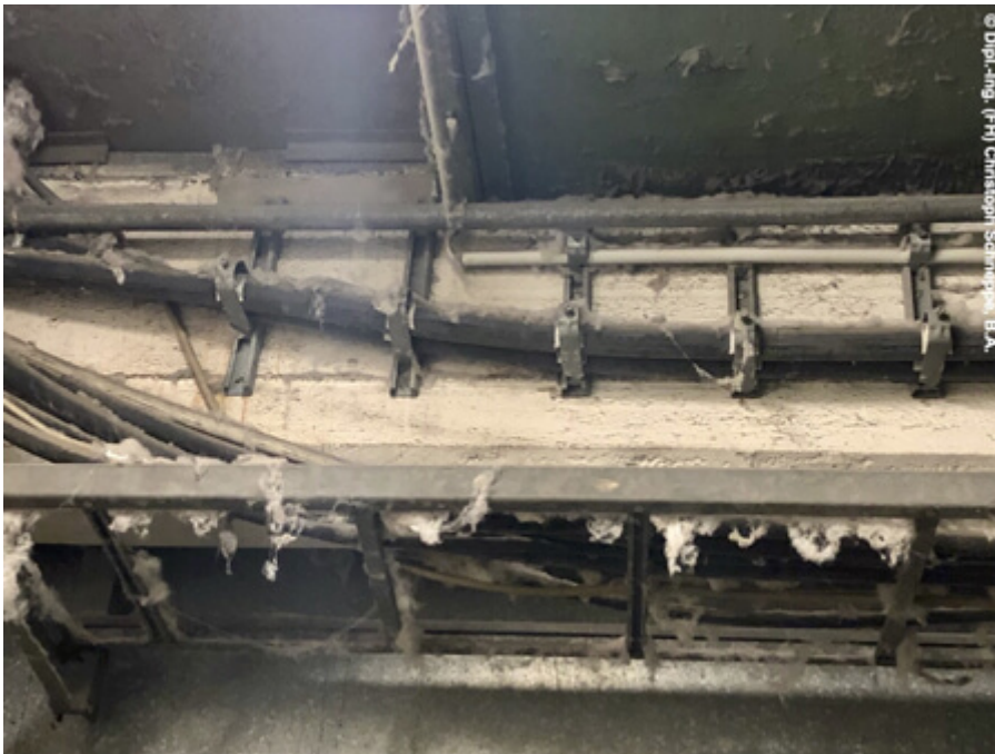
Weiträumige Verteilung von Textilfasern und Ablagerung auf elektrischen Betriebsmitteln (Bildquelle: Dipl.-Ing. (FH) Christoph Schneppe, B.A.)
