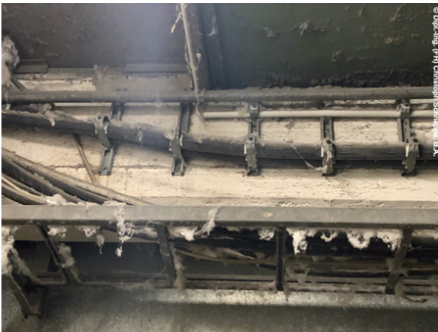
Weiträumige Verteilung von Textilfasern und Ablagerung auf elektrischen Betriebsmitteln (Bildquelle: Dipl.-Ing. (FH) Christoph Schneppe, B.A.)
