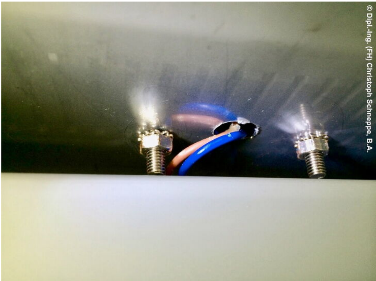
Basisisolierte Leitungsadern ohne ausreichenden Kantenschutz
