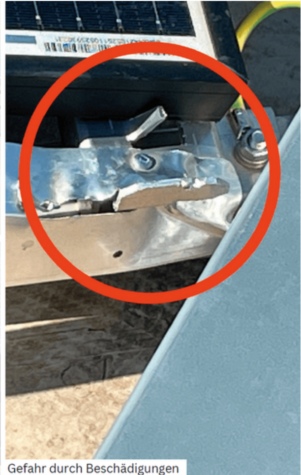
Gefahr durch Beschädigungen
