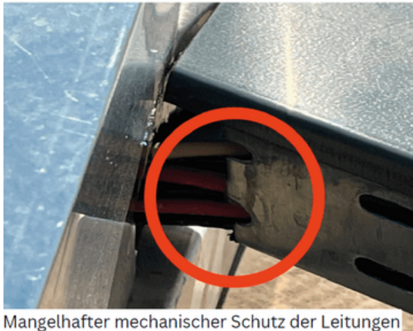
Mangelhafter mechanischer Schutz der Leitungen
