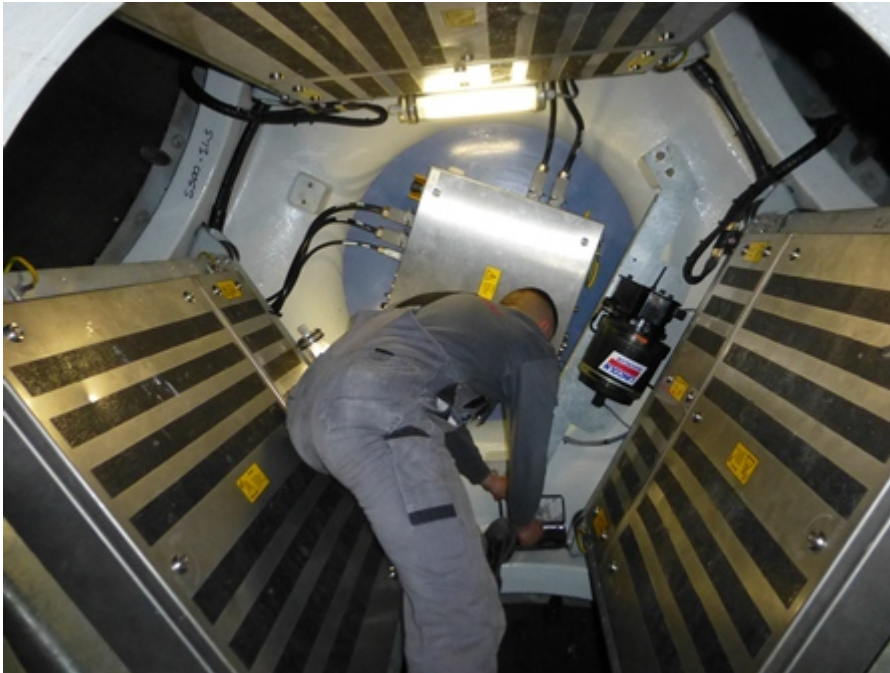
Abb. 5: Innenbereich der Nabe
