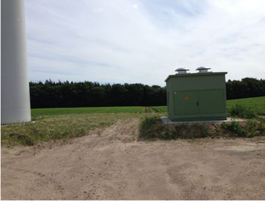
Abb. 4: Typische Installationsanordnung der Mittelspannungs-Einrichtungen bei einer Multimegawatt-Windenergieanlage
