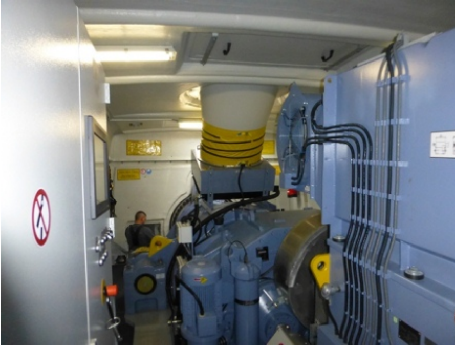
Abb. 3: Maschinenhaus einer Multimegawatt-Windenergieanlage
