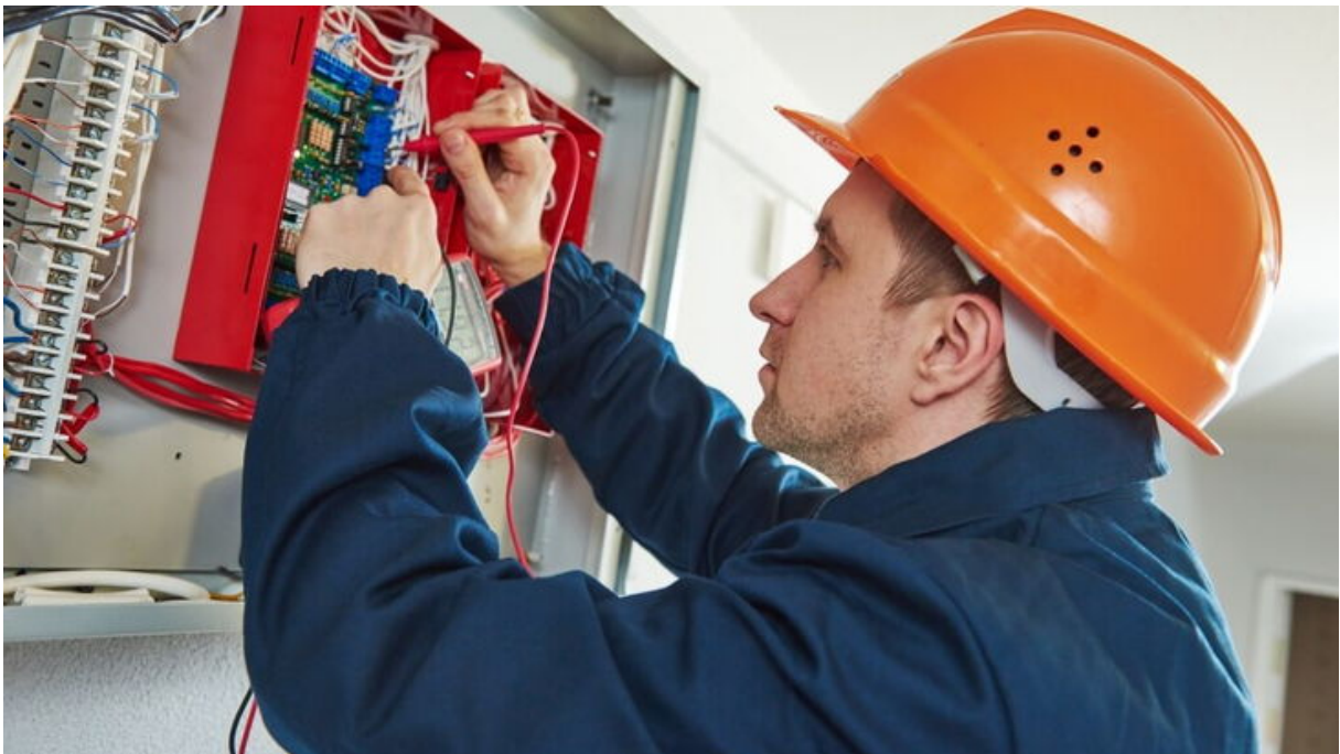
Prüfen Sie die elektrischen Anlagen nach einem Hochwasser. (Bildquelle: kadmy/iStock/Thinkstock)
