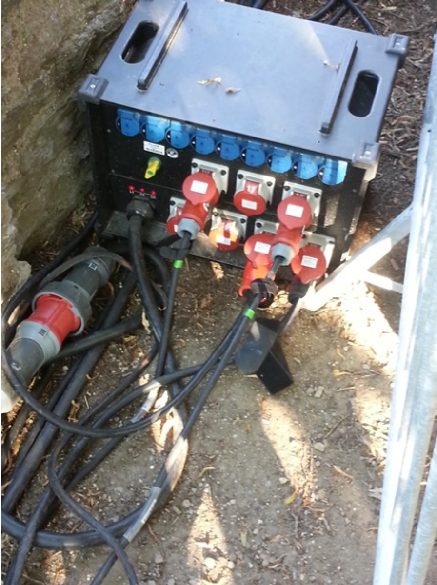
Tragbarer Baustromverteiler im Baustelleneinsatz (Bildquelle: Dr. Friedhelm Kring)
