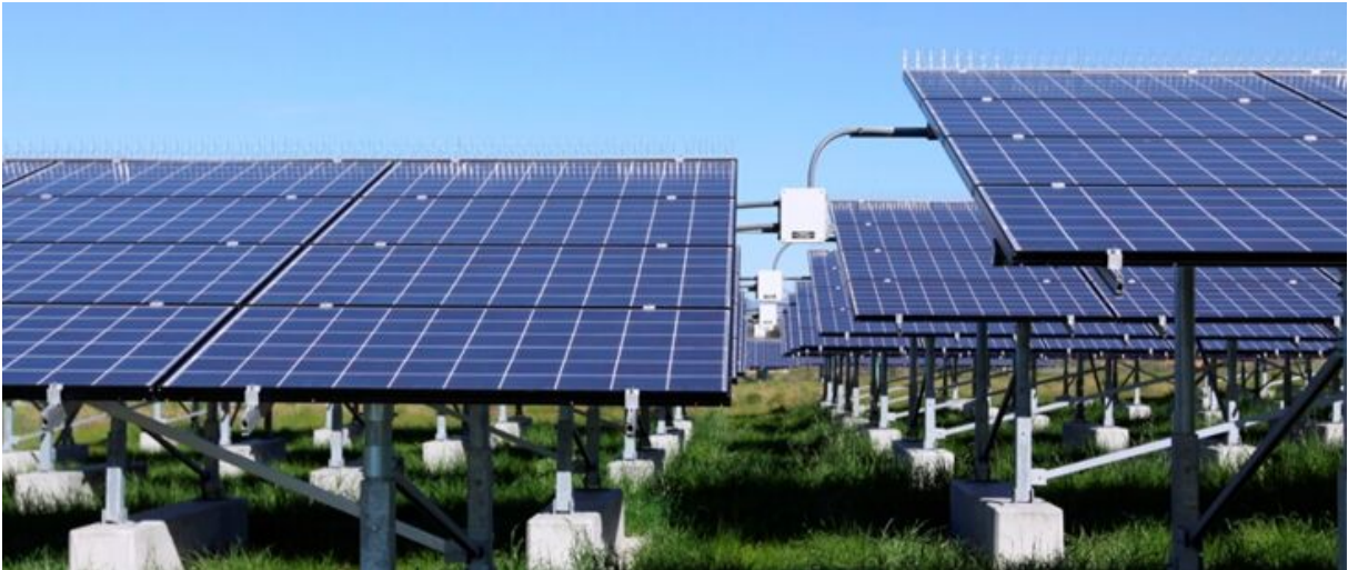
Photovoltaikanlage nach dem derzeitigen Stand der Technik (Bildquelle: Stocktreck Images/Stocktreck Images/Getty Images)
