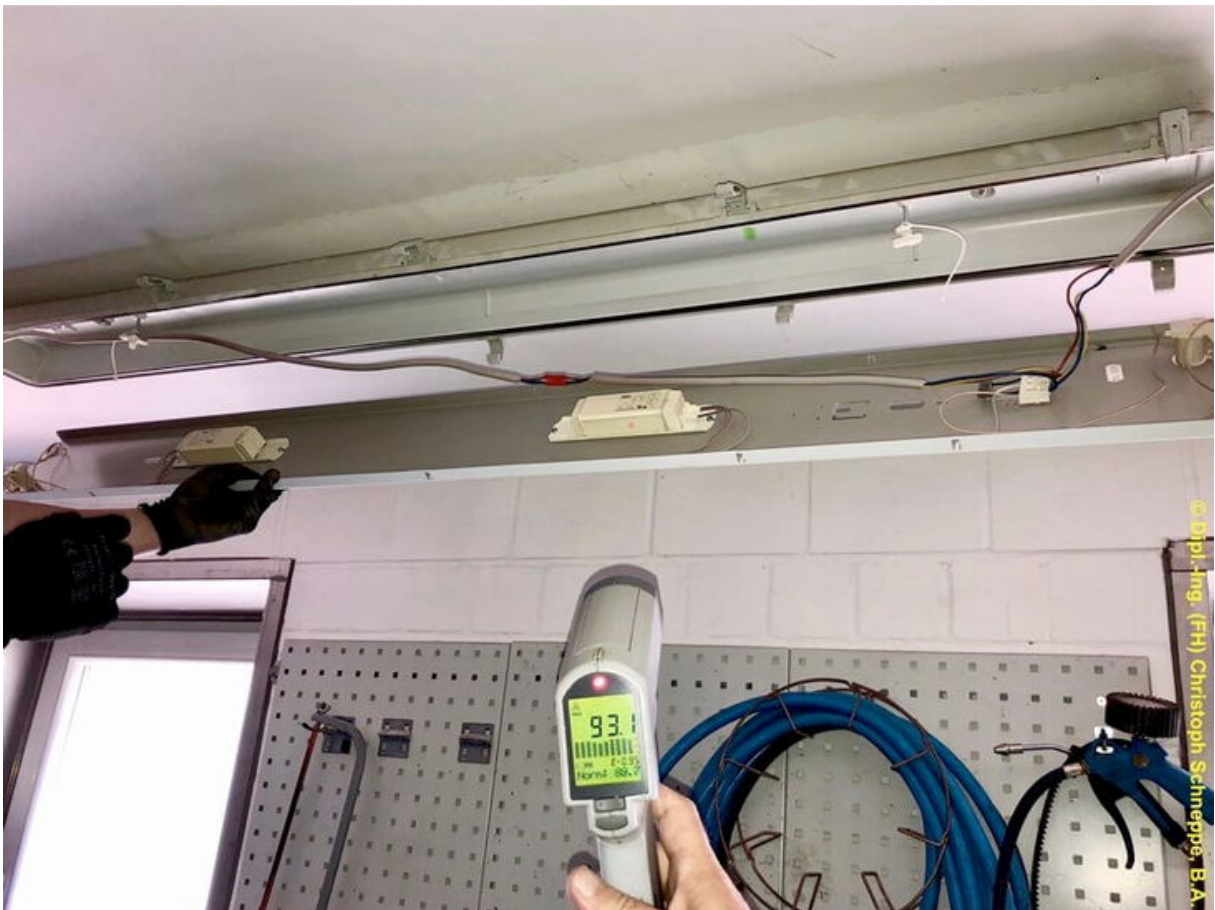
Bei Oberflächentemperaturen von über 90 °C sind Schädigungen der Leitungsisolierungen der Durchverdrahtung nicht auszuschließen. (Bildquelle: Dipl.-Ing. (FH) Christoph Schneppe, B.A.)
