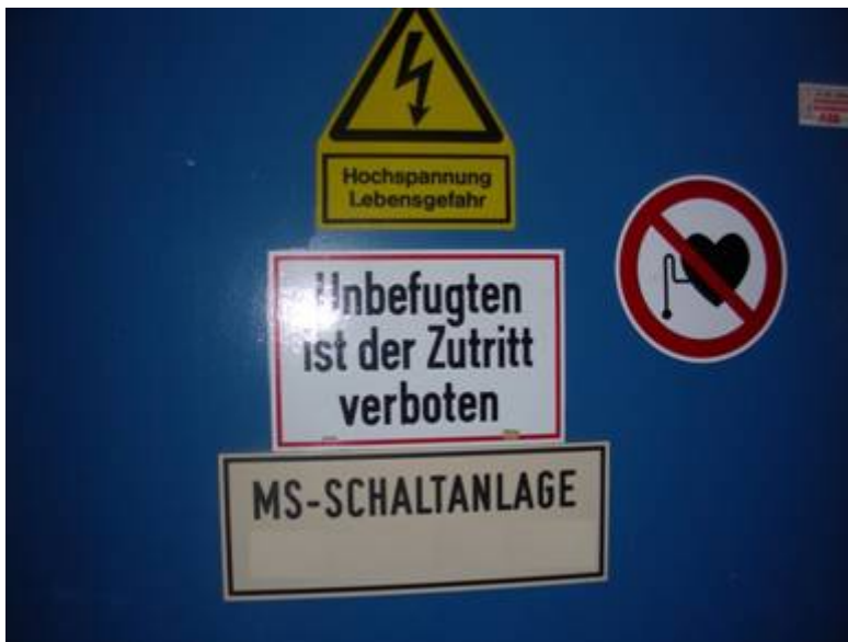
Beispiel „Abgeschlossene elektrische Betriebsstätte“
