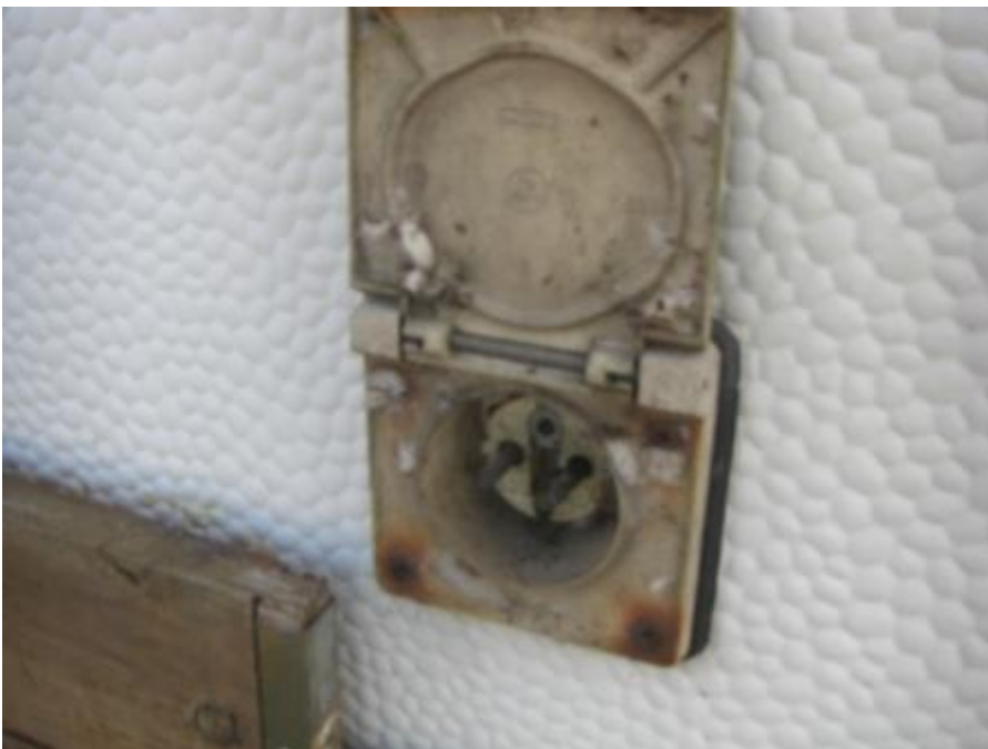
Schon lange nicht mehr erlaubt: Schukoanschluss am Caravan.
