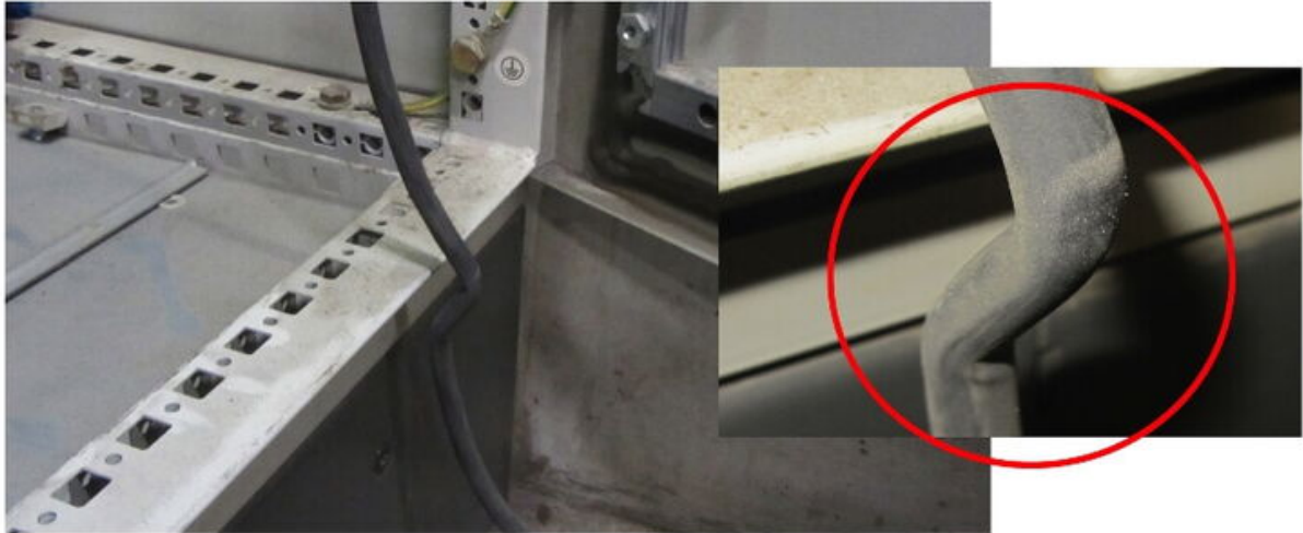
Ein typischer Installationsfehler. (Bildquelle: Jörg Belzer, B. Eng., MBA)
