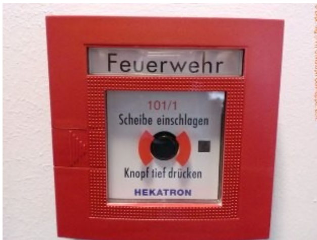
Nicht automatischer Brandmelder (DKM)
