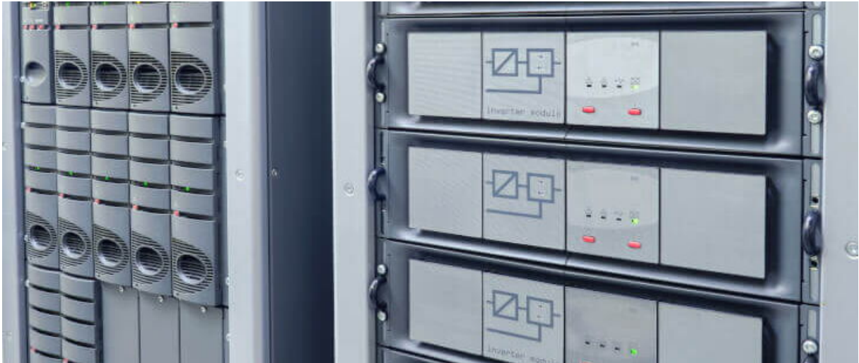
Batteriesysteme in Rechenzentren: Zentrale USV-Module sichern die Energieversorgung und überbrücken Netzstörungen. © Andrey Zhuravlev/iStock/Getty Images Plus
