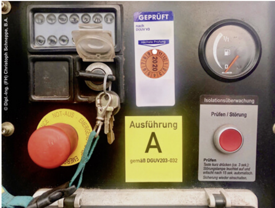
Kennzeichnung eines Stromerzeugers als Ausführung A gemäß DGUV I 203-032
