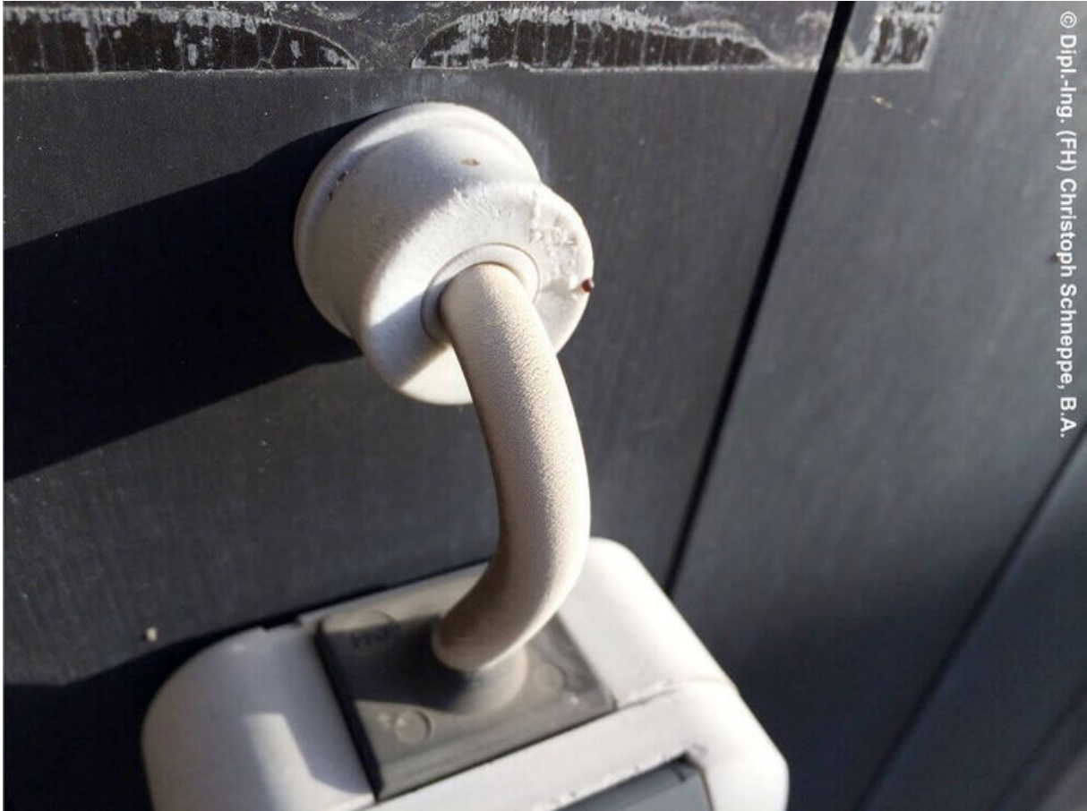
Ungeschützt gegen direkte Sonneinstrahlung verlegte NYM-Leitung
