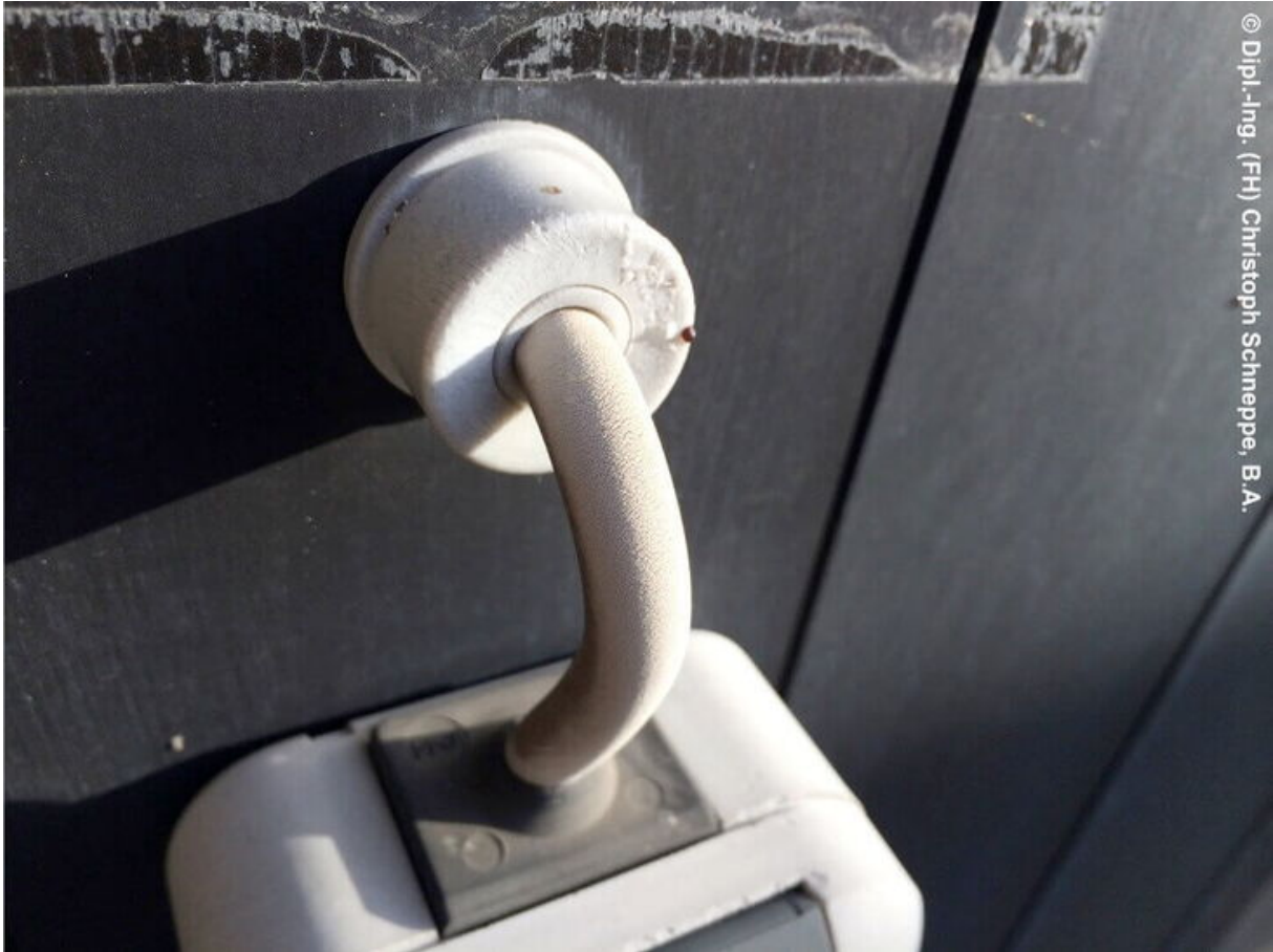
Ungeschützt gegen direkte Sonneinstrahlung verlegte NYM-Leitung
