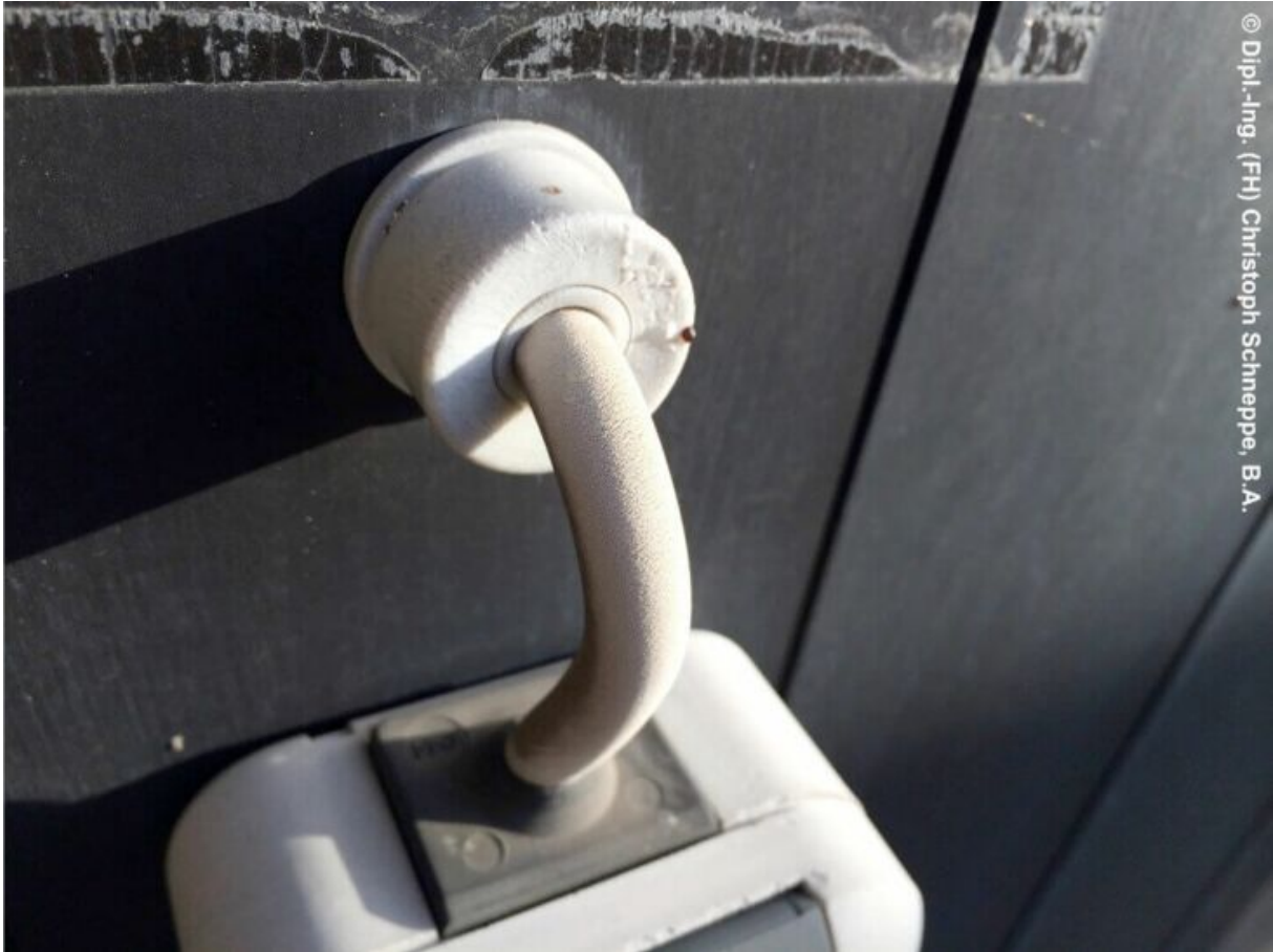
Ungeschützt gegen direkte Sonneinstrahlung verlegte NYM-Leitung
