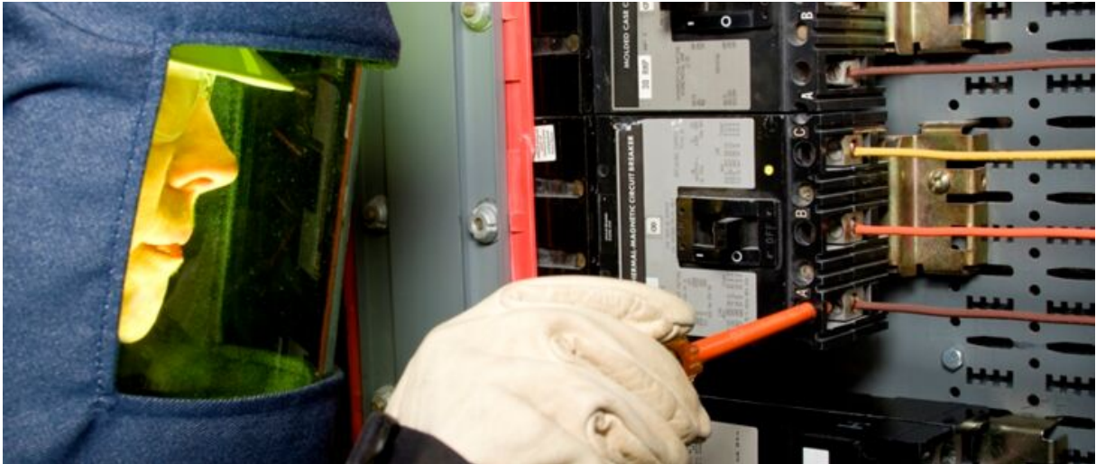
Arbeiten unter Spannung (AuS): Werkzeuge und Schutzausrüstung sicher einsetzen (Bildquelle: ReggieLavoie/iStock/Getty Images)
