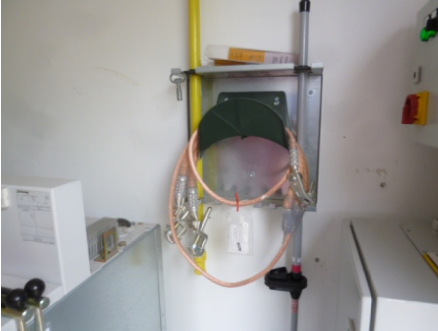
Abb. 3: Brandschaden, verursacht durch verpolte Stringverkabelung im Generatoranschlusskasten (Quelle: Fa. K&S)
