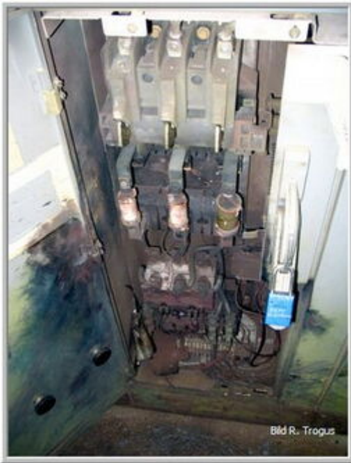
Abb.: Auswirkungen eines Lichtbogens (2)
