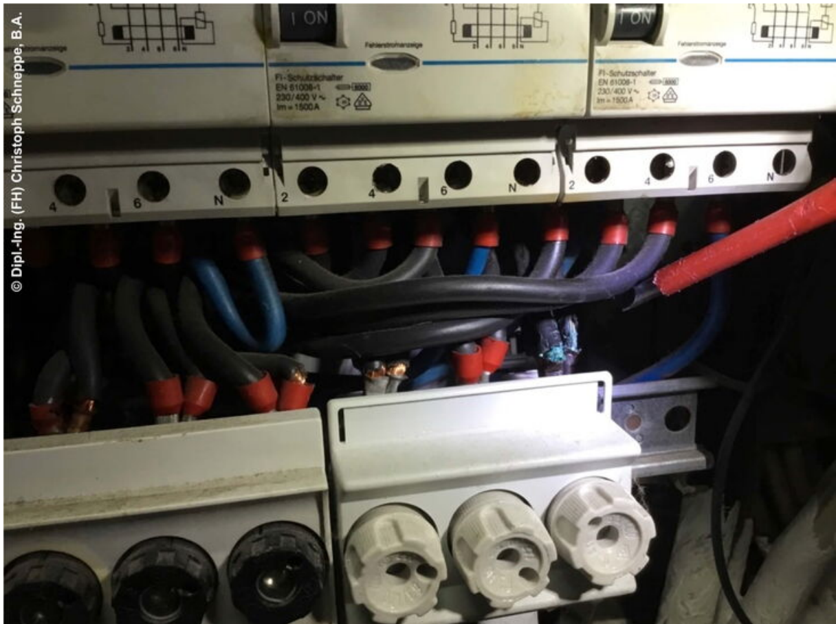
Thermisch überlastetes Sicherungselement
