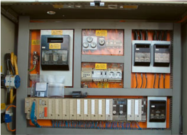
Abb. 1a: Beispiel für die ordnungsgemäße Ausführung des Handrücken- bzw. Fingerschutzes in einem Schaltschrank. Die Betriebsmittel auf der Leiste der Schubeinsatztechnik weisen einen teilweisen Berührungsschutz auf
