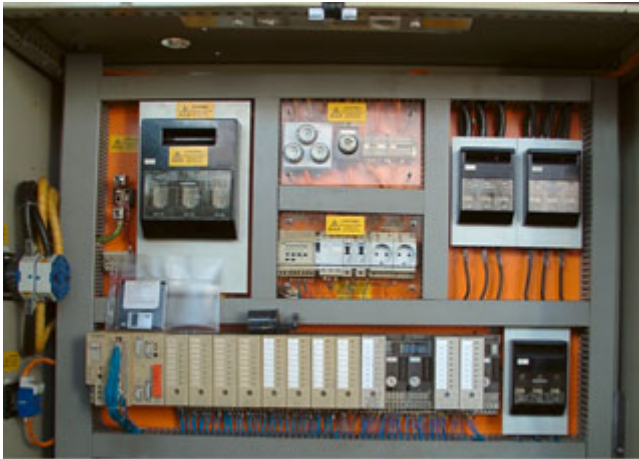
Abb. 1a: Beispiel für die ordnungsgemäße Ausführung des Handrücken- bzw. Fingerschutzes in einem Schaltschrank. Die Betriebsmittel auf der Leiste der Schubeinsatztechnik weisen einen teilweisen Berührungsschutz auf
