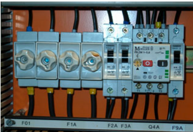
Abb. 1b: An dieser Schaltgerätekomination ist das Prinzip des teilweisen Berührungsschutzes gut zu erkennen. Alle aktiven Teile sind so verkleidet und versenkt, dass eine zufällige Berührung verhindert wird
