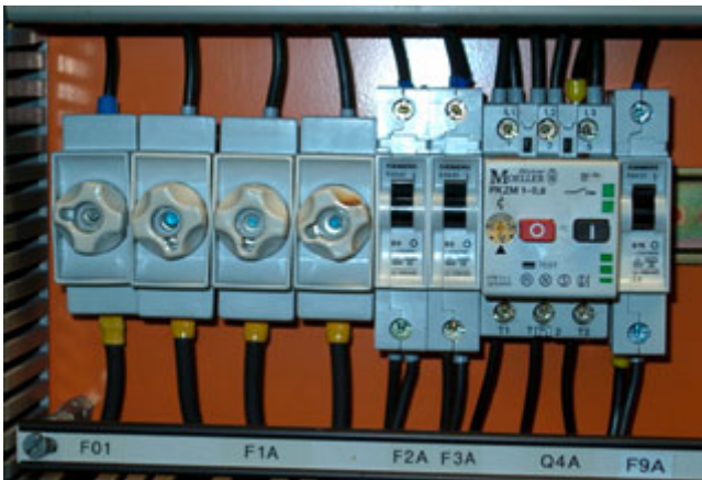
Abb. 1b: An dieser Schaltgerätekombination ist das Prinzip des teilweisen Berührungsschutzes gut zu erkennen. Alle aktiven Teile sind so verkleidet und versenkt, dass eine zufällige Berührung verhindert wird
