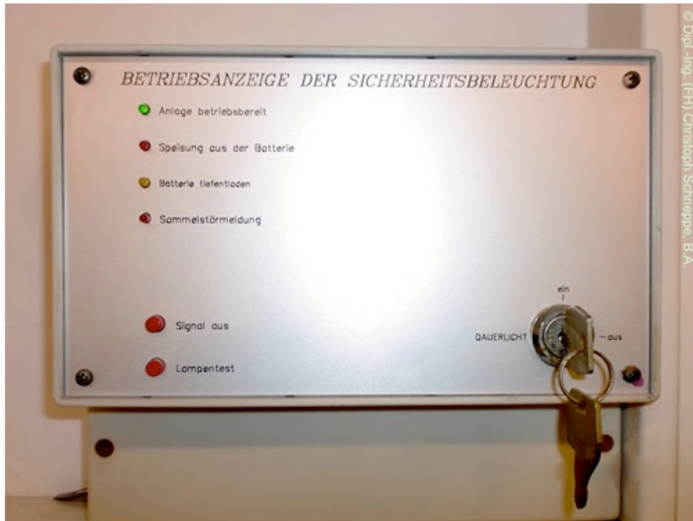
Betriebs- und Störmeldeanzeige einer Sicherheitsbeleuchtungsanlage mit Zentralbatterie
