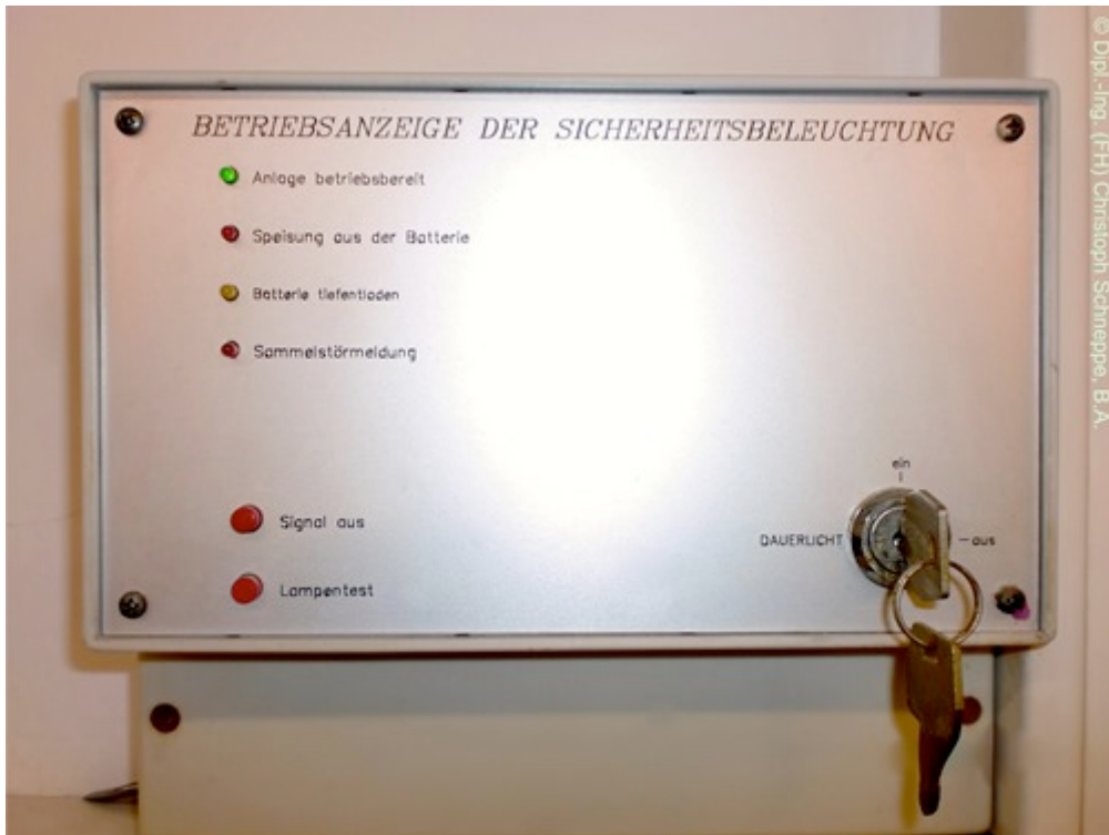
Betriebs- und Störmeldeanzeige einer Sicherheitsbeleuchtungsanlage mit Zentralbatterie
