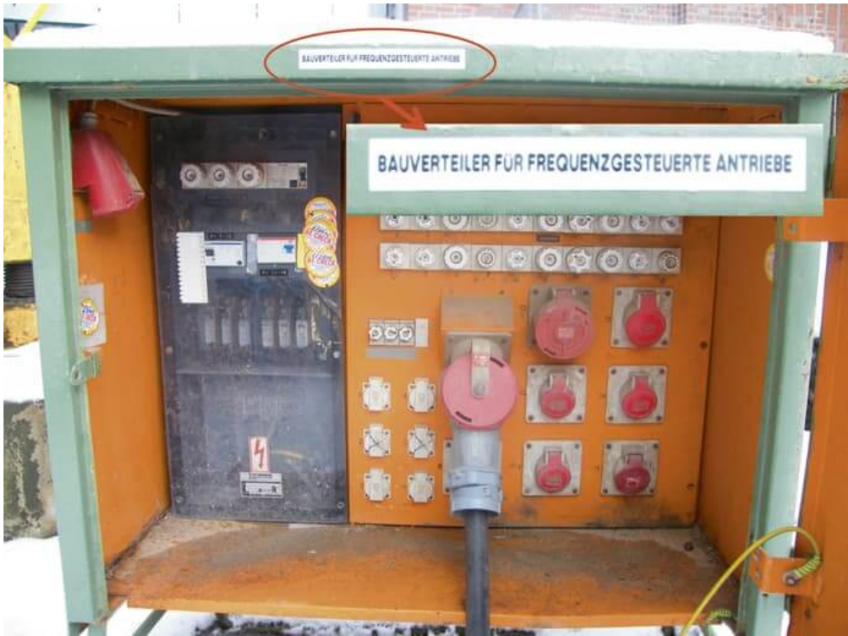
Abb. 1: Baustromverteiler für frequenzgesteuerte Antriebe
