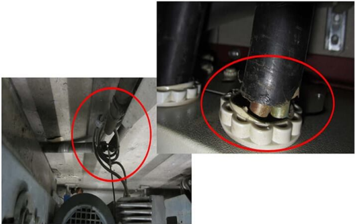
Typische Mängel aufgrund Nutzung und Verschleiß (Bildquelle: Jörg Belzer, B.Eng., MBA)
