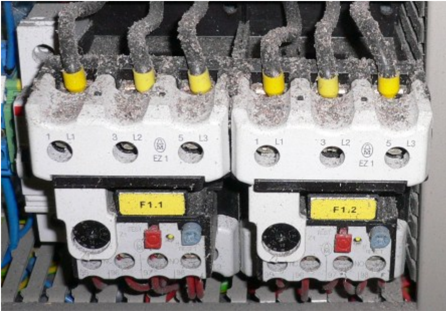
Verunreinigung von Anlagenteilen führt zu Störungen. (Bildquelle: Jörg Belzer, B.Eng.)
