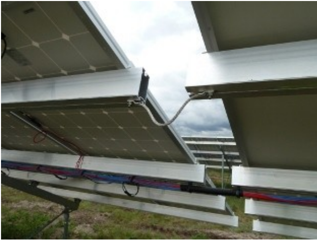
Niederohmige Verbindung von zwei Modulgestellen bei einer Photovoltaik-Freifeldanlage (eigene Aufnahme)
