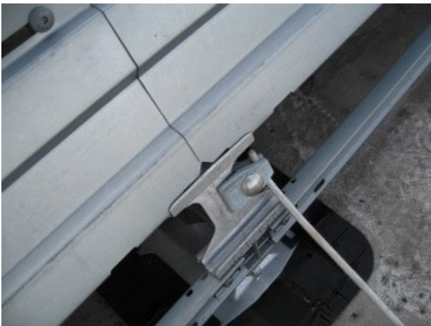
Anbindung eines Modulgestells einer PV-Aufdachanlage an den bestehenden Gebäudeblitzschutz (eigene Aufnahme)
