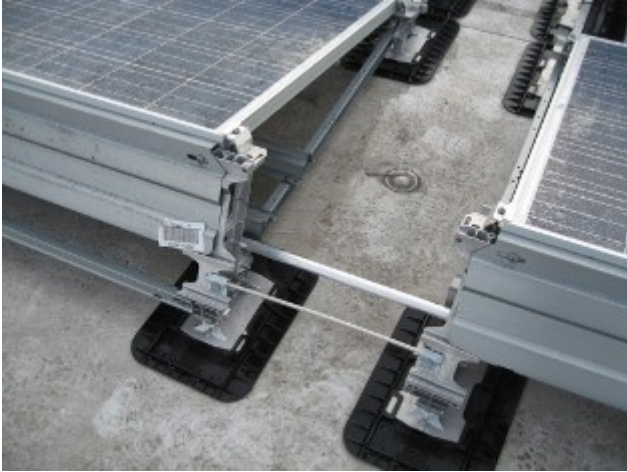
Anbindung von mehreren Modulgestellen einer Photovoltaik-Aufdachanlage (Quelle: eigene Aufnahme)
