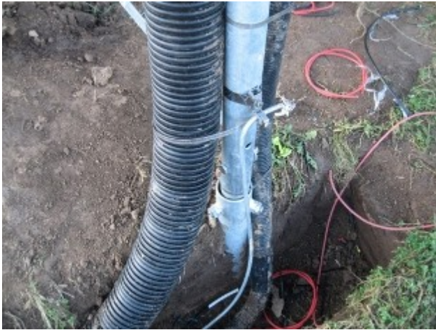
Anbindung des Modulgestells einer Photovoltaik-Freifeldanlage (eigene Aufnahme)
