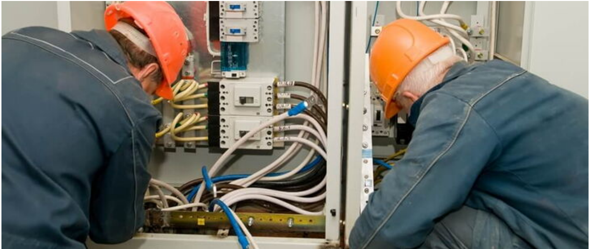
Fehler in elektrischen Anlage gefährden das Instandhaltungspersonal. (Bildquelle: kadmy/iStock/Getty Images)
