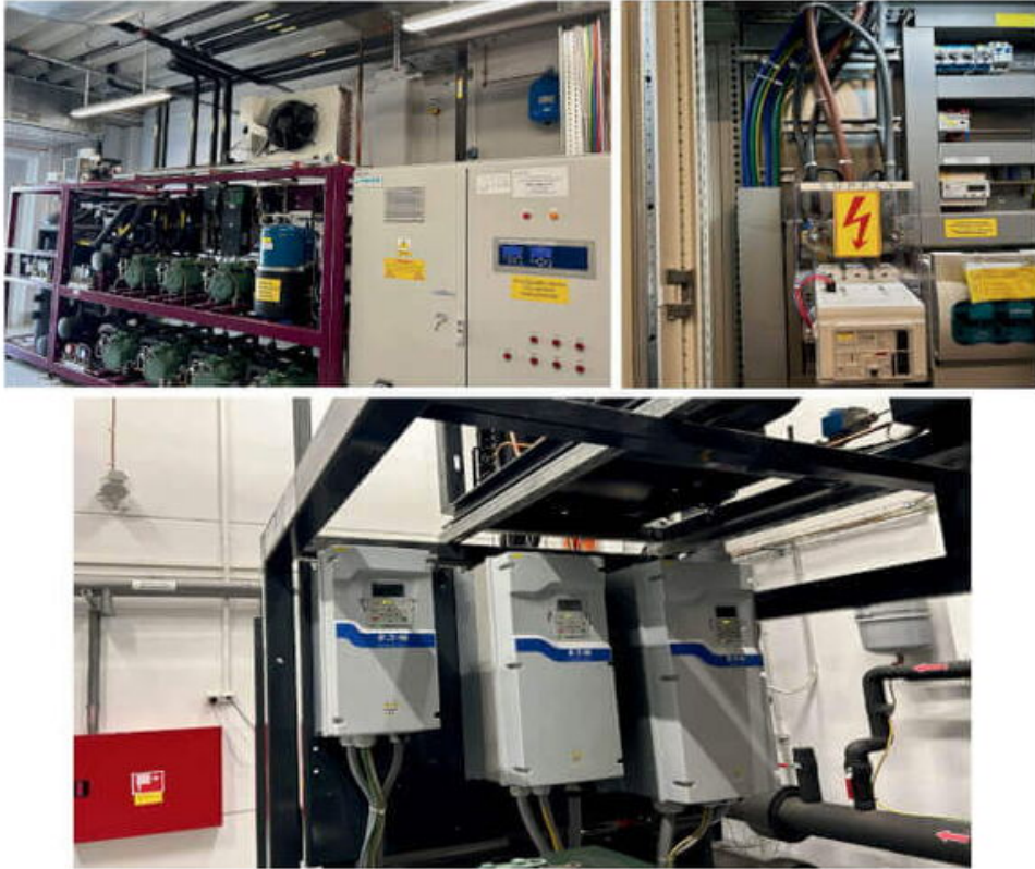
Elektrotechnischer Aufbau einer Gewerbekälteanlage (Bildquelle: Jörg Belzer, B.Eng., MBA)
